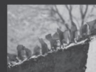
Cacos de Vidro nos Muros
